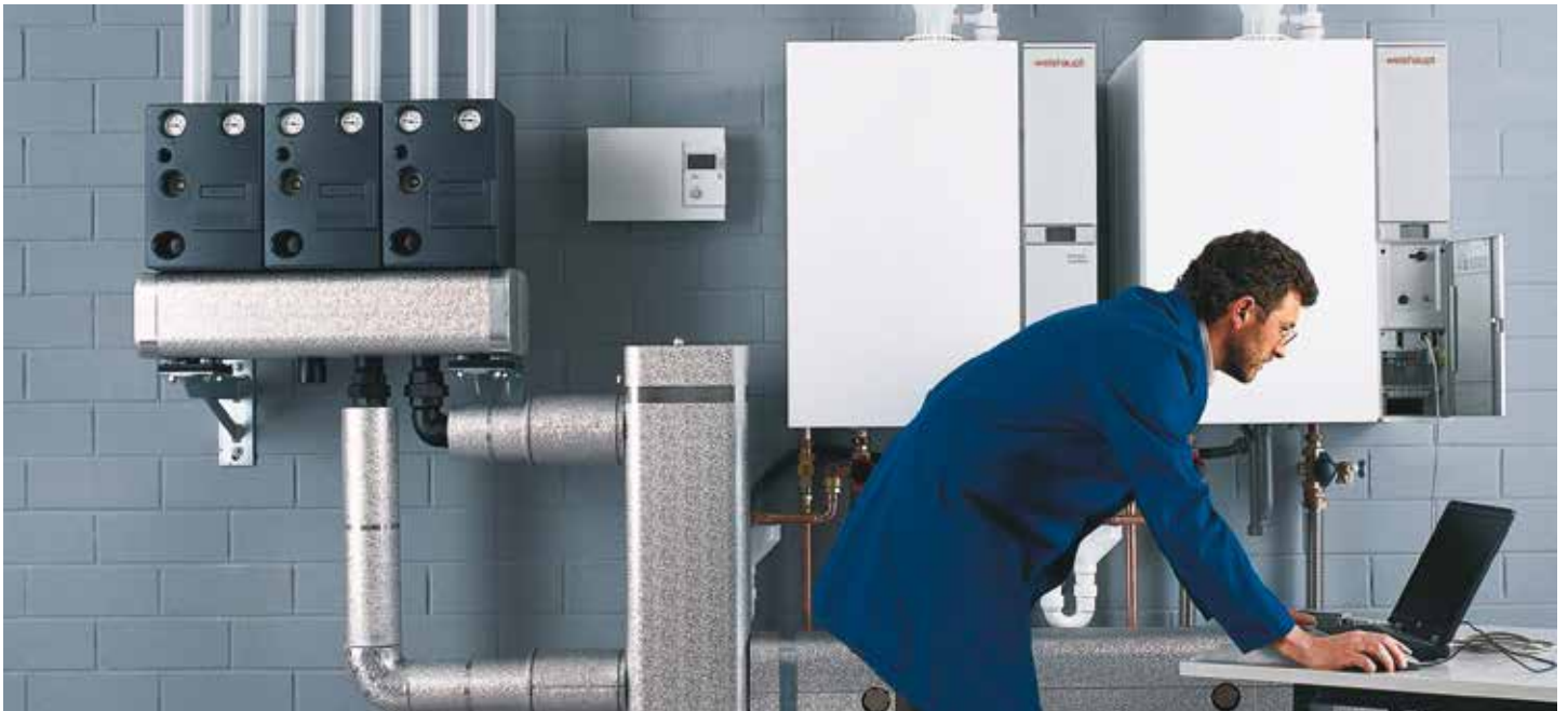
Wartung einer Weishaupt Thermo Condens-Kaskade
