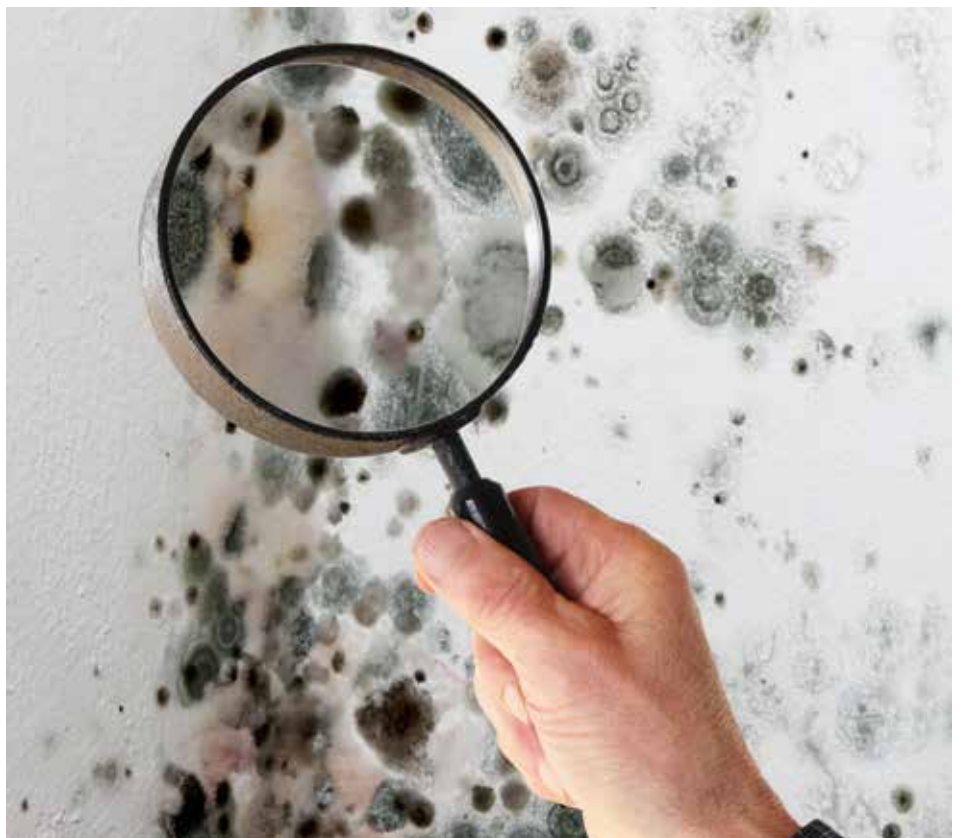
Schimmelbildung bei feuchter Raumluft
